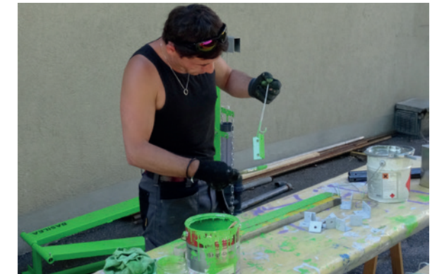
Application de peinture sur une pompe BASILEA
